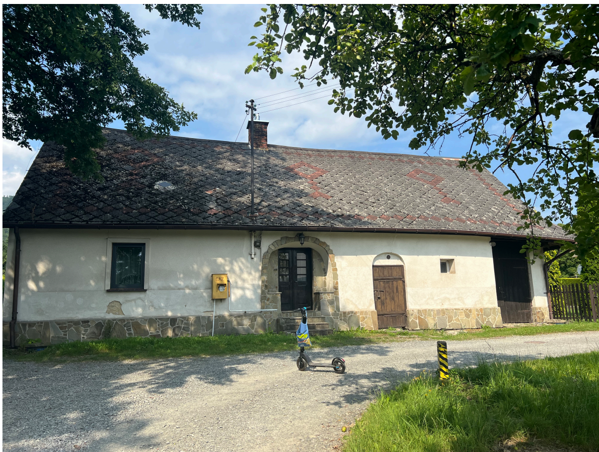
Rysunek 6 Dach pokryty płytami azbestowymi płaskimi (budynek przykładowy)
